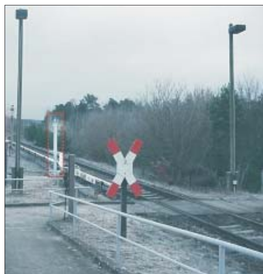
Abb. 3 • S-Bahn Berlin GmbH Linie S1 IR Transmitter neben dem Gleisbett
